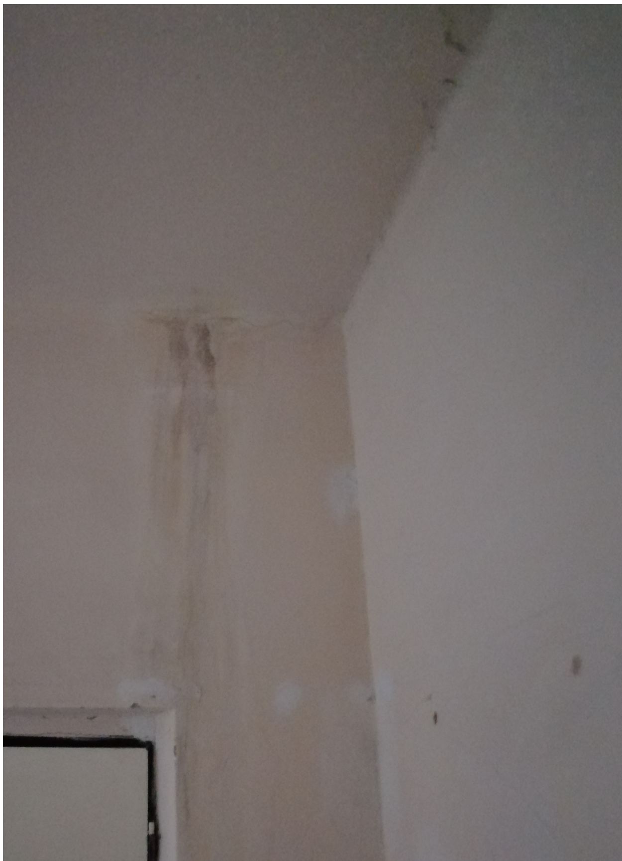
Obrázok č.7: Poškodená omietka stropu a stien po zatekaní
