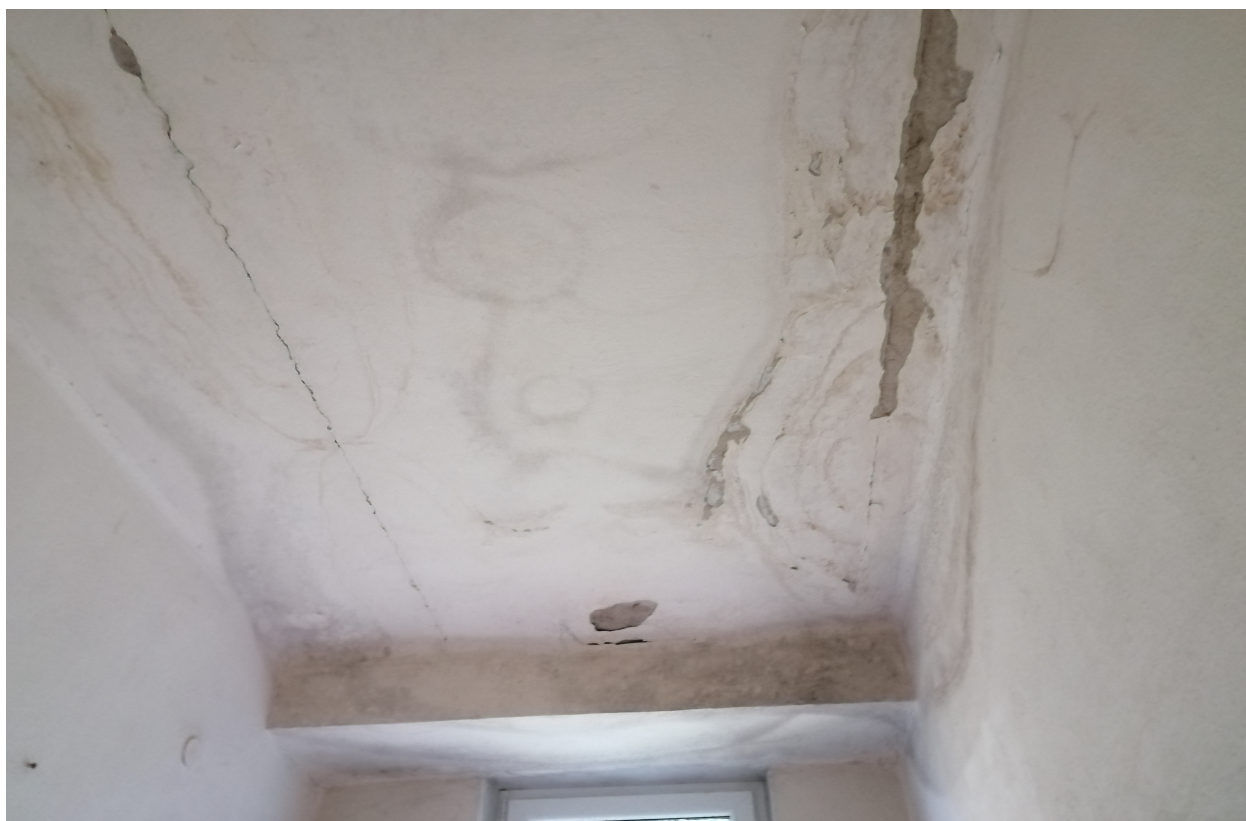
Obrázok č.6: Poškodená omietka stropu po zatekaní
