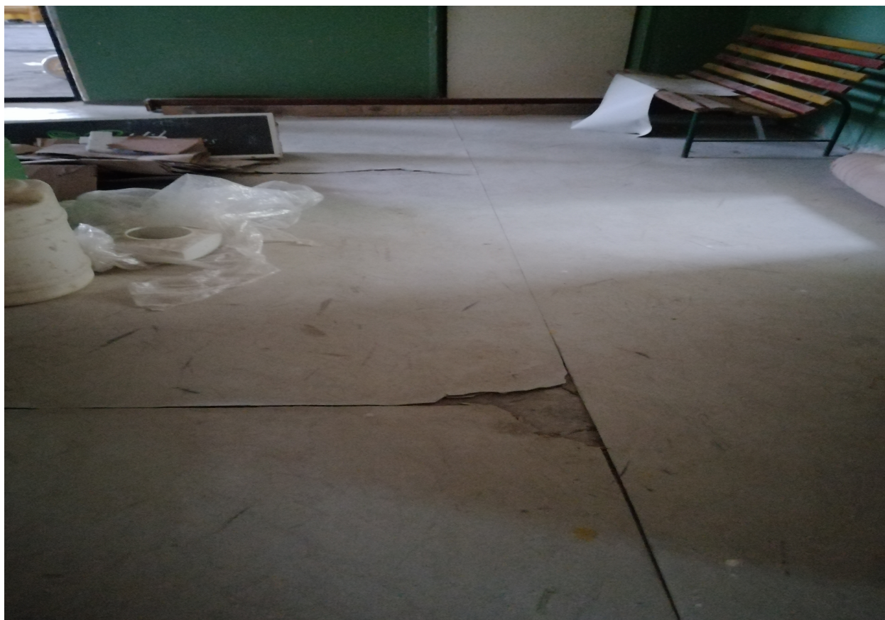
Obrázok č.5: Poškodená podlaha na chodbe
