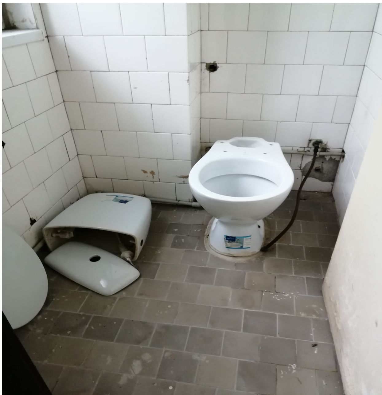
Obrázok č.1: Záchodová kabína s nefunkčnou záchodovou misou
